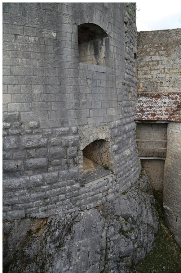
Troisième enceinte : base de la tour du Fer à Cheval. Le parement bossagé date de la fin du XVe s., les ouvertures de tir et la partie supérieure correspondent aux réaménagements tardifs (cl. V. Chevassu, 2017).
