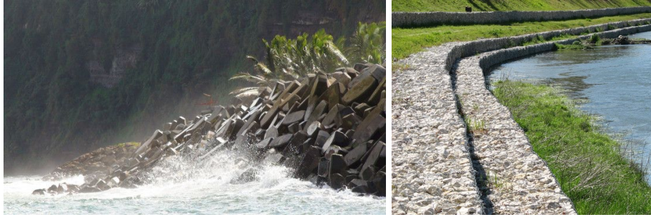
Fig 4 Ouvrages de protection utilisés pour réduire l'impact des ondes de batillage sur les berges des canaux navigables : carapaces (à gauche) et gabions (à droite) [Concrete Layer Innovations, 2002].
