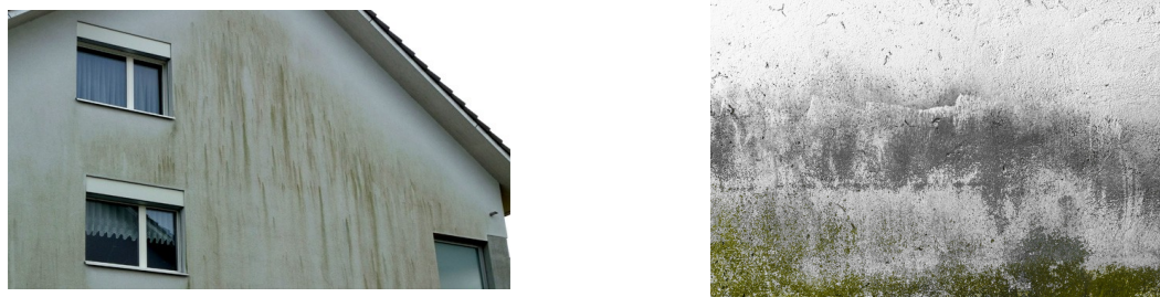
FIGURE 2 – Exemples de développements biologiques à la surface de façades
