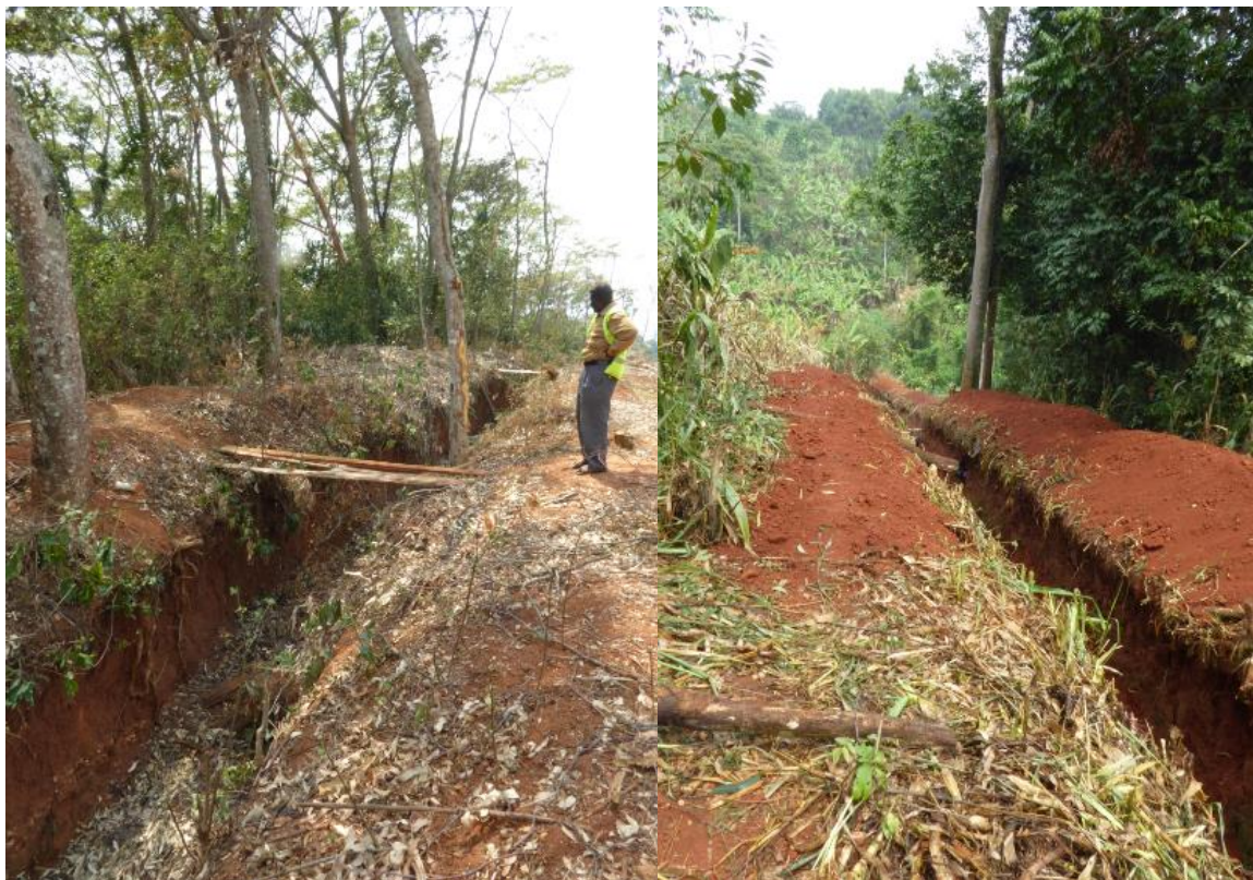
Figure 24 : Tranchée du village de Nyakabingo, à gauche avant restauration, à droite après restauration.
