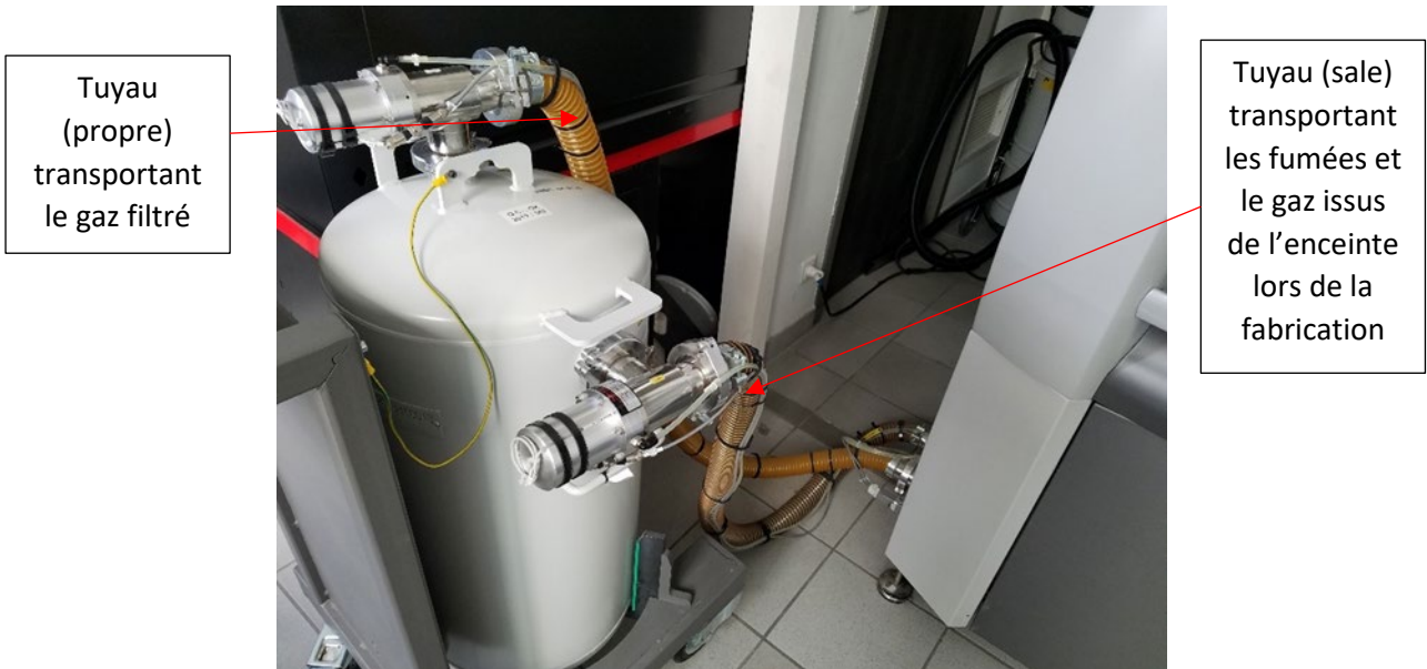
Figure 60 - Filtre externe servant à collecter les fumées et à réinjecter le gaz filtré dans l'enceinte. On peut remarquer que le filtre est relié à la terre pour éviter les décharges électrostatiques à l'intérieur du filtre.
