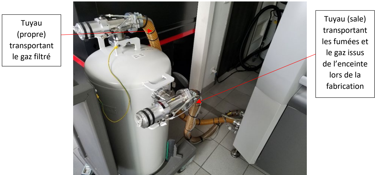
Figure 60 - Filtre externe servant à collecter les fumées et à réinjecter le gaz filtré dans l'enceinte. On peut remarquer que le filtre est relié à la terre pour éviter les décharges électrostatiques à l'intérieur du filtre.
