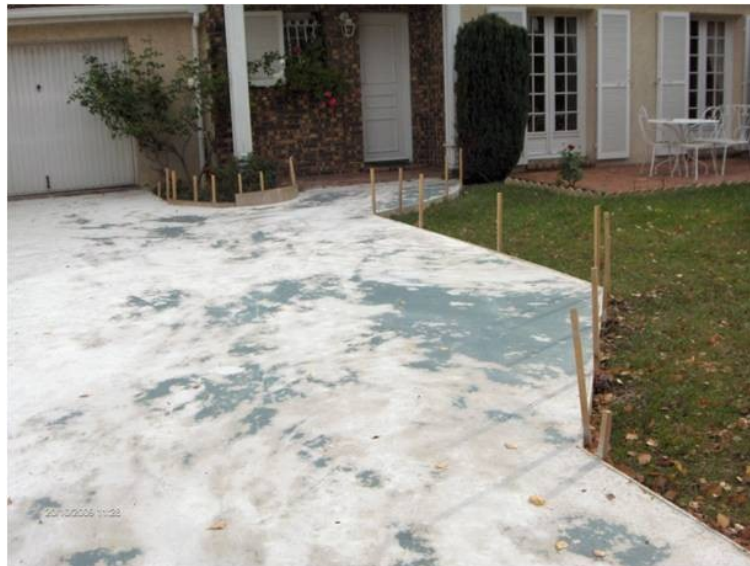
Figure 1.7 : Verdissage observé sur une terrasse à base de ciment au laitier. (Photo : Lafarge)
