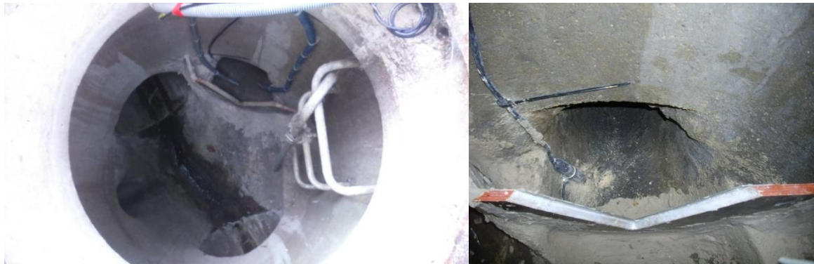
Figure II.20: Regard d'instrumentation du parking référence, et zoom sur le déversoir triangulaire en mince paroi
