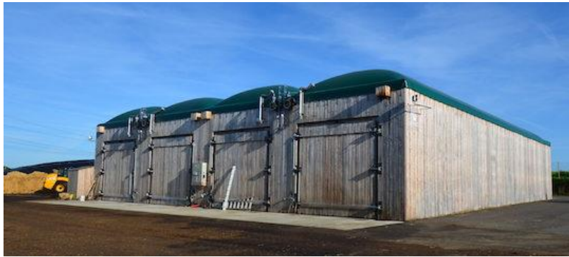
Figure 14 : Digesteur de type garage ( bioenergie-promotion.fr )
