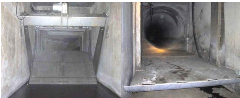
déversoir régulé par une vanne secteur
