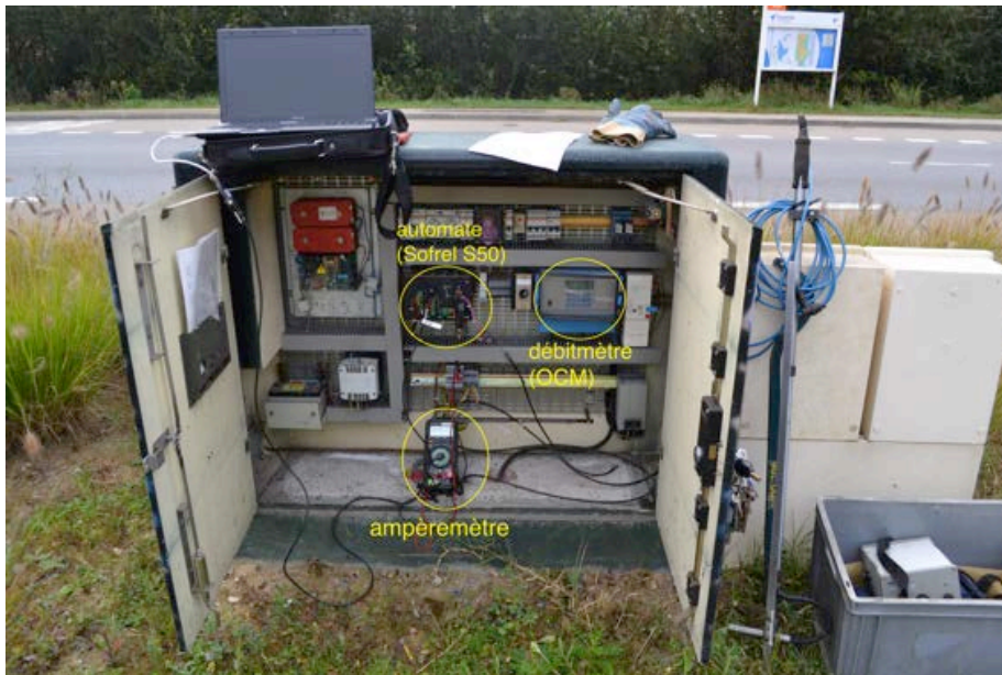
Armoire électrique du site : l'ampèremètre est branché sur la boucle sonde piézo.-Sofrel pour mesurer le signal électrique émis par la sonde.
