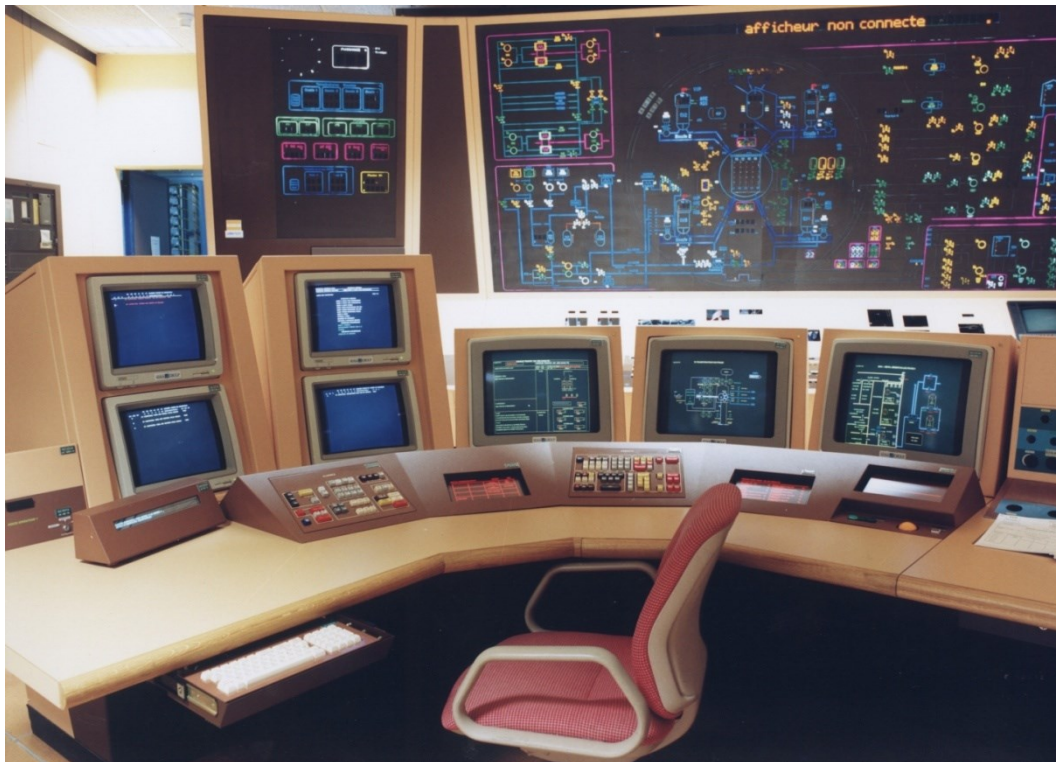
Figure 11 : Photo de salle de commande informatisée 2 18
