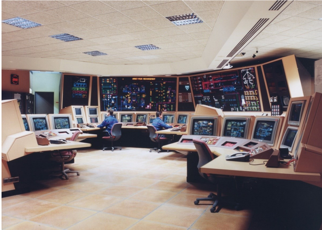
Figure 10 : Photo de salle de commande informatisée 1
