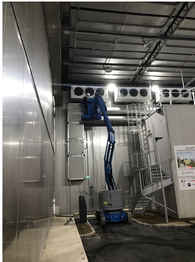
FIGURE 2.2 – Vue d'une partie du système de ventilation de la chambre climatique de Sense-City, incluant quelques blocs de ventilation, une gaine d'extraction d'air et 2 pulseurs. Photo prise lors d'une campagne de mesures des vitesses des ventilateurs
