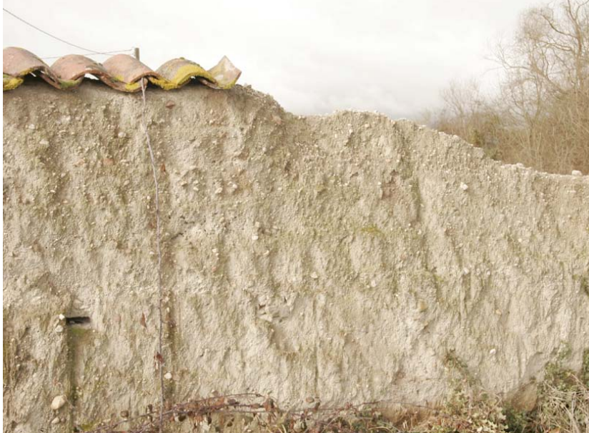
Érosion naturelle du mur (détail)
