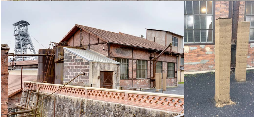
Supports, début d'érosion
