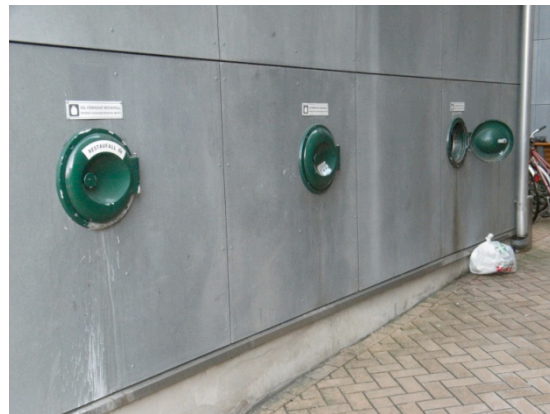
Installation de tris de déchets – Bo01 – Source : Auteure, 2010
