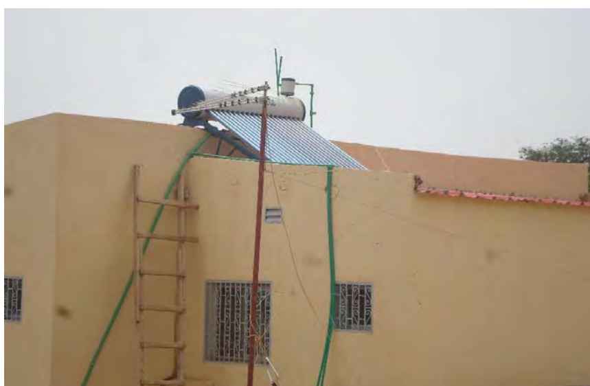
Photo 61 : Chauffe-eau solaire dans un ménage Niaméen Source : Abdourazack N. A., 2018
