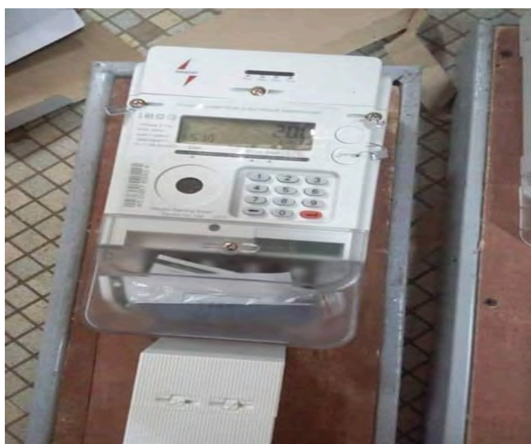
Photo 57 : Compteur à prépaiement commercialisé par la NIGELEC Source : NIGELEC, 2018
