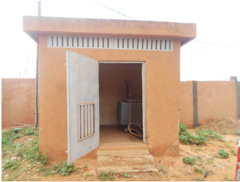
Photo 20 : Poste Cabine cité de la Francophonie Source : Abdourazack N. A., 2018
