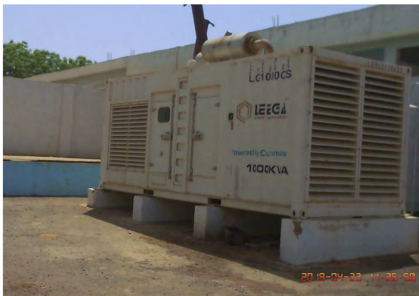
Photo 54 : Groupe électrogène de la société SAFI S.A.
