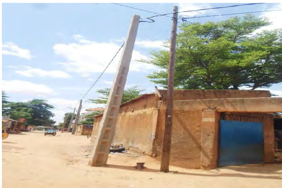
Photo 38 : Renforcement d'une ligne électrique saturée Source : Abdourazack N. A., 2018
