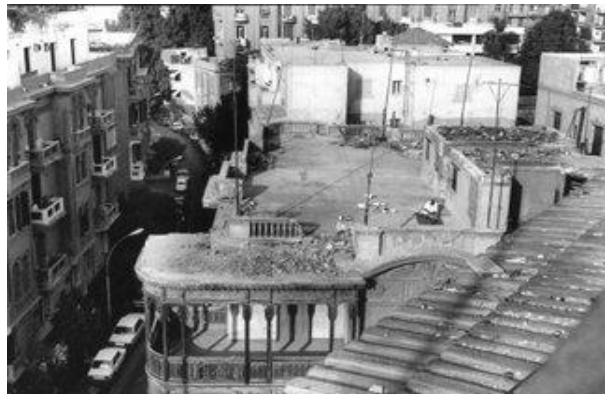
Figure 3.2.5. Toit dégradé d'un immeuble sur la rue Sabry Abo Alam.
