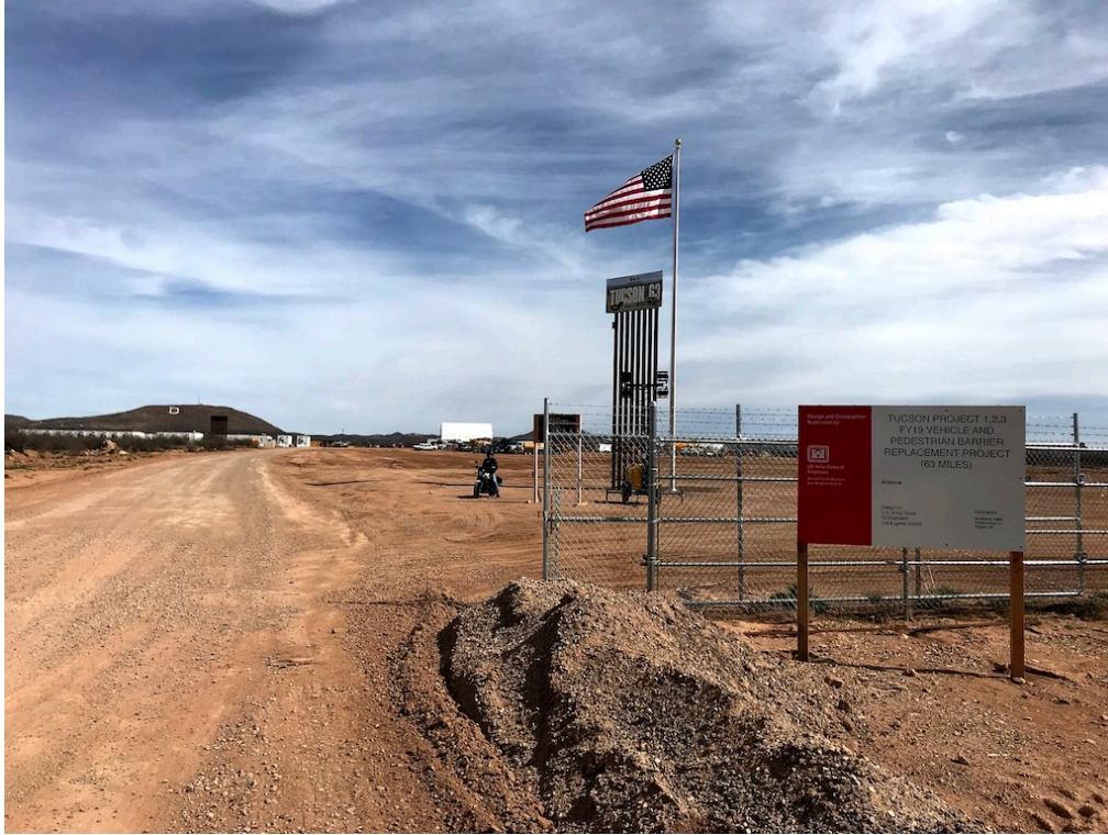
Photo 8. Site de construction de la nouvelle barrière à Douglas (C. Fortuné, Douglas, février 2020)
