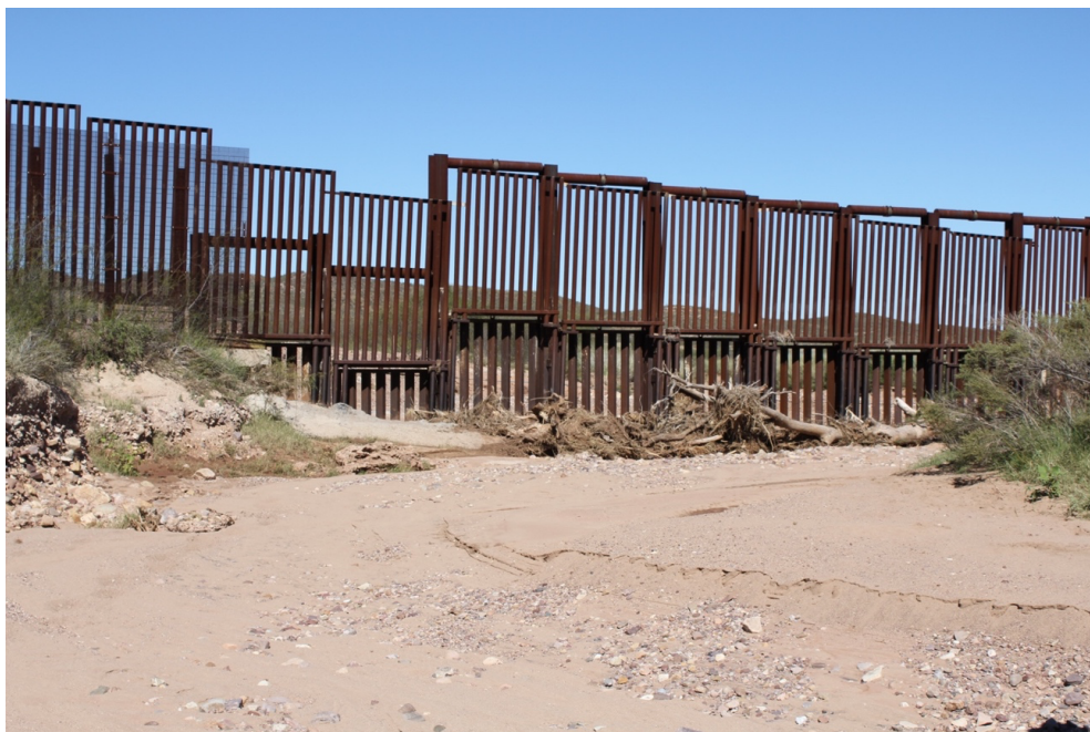
Photo 23. Débris (troncs d'arbres, branches, etc.) qui se sont accumulés lors d'une flash flood à l'est d'Agua Prieta. Les portes qui se soulèvent permettent de les laisser passer si besoin (C. Fortuné, Agua Prieta, novembre 2018)
