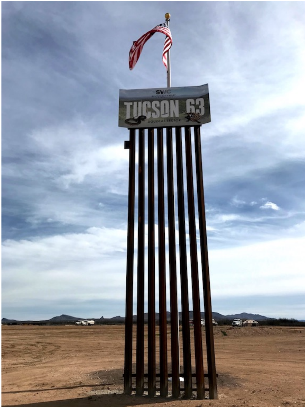
Photo 7. Modèle de la nouvelle barrière en construction à Douglas (C. Fortuné, Douglas, février 2020)
