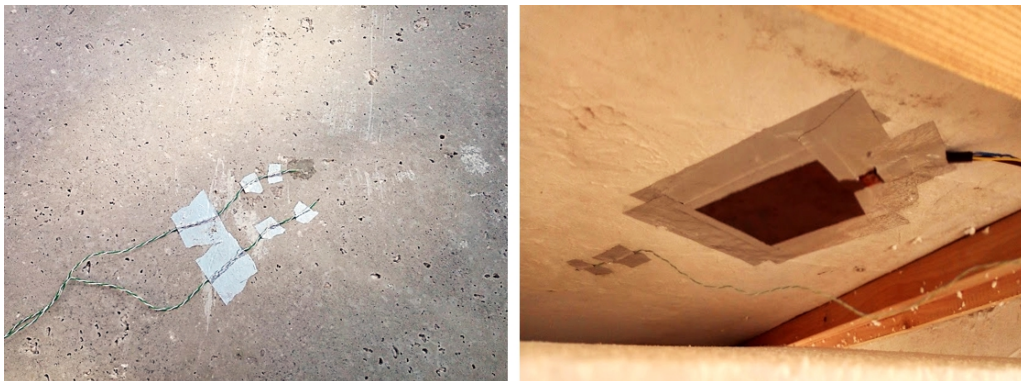
Figure 70. Plaques de béton équipées de thermocouples et fluxmètres
