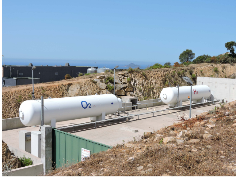
FIGURE 2.26 – Photographie des réservoirs de stockage H_2 et O_2
