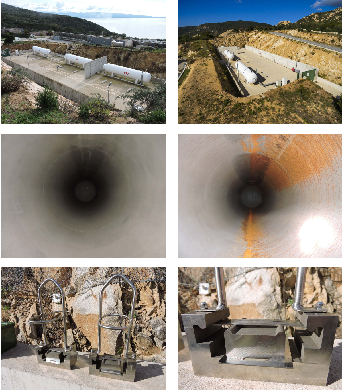
FIGURE G.1 – Photographies complémentaires du sous-système stockage. De gauche à droite et de haut en bas : (a-b) Vue de l'ensemble des réservoirs (c) Vue de l'intérieur du réservoir d'hydrogène (d) Vue de l'intérieur du réservoir d'oxygène (e-f) Éprouvettes pour l'étude de la fragilisation de l'acier en présence d'hydrogène
