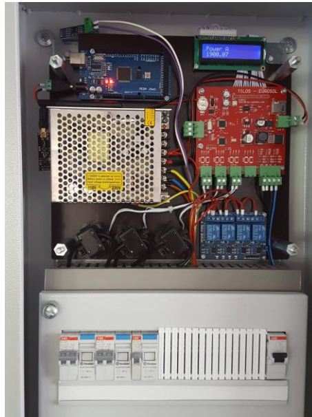
Figure I-16: Installation chez le client du système de mesures avancé et du dispositif de communication avec la SCADA (source : Facebook Tilos Horizon)
