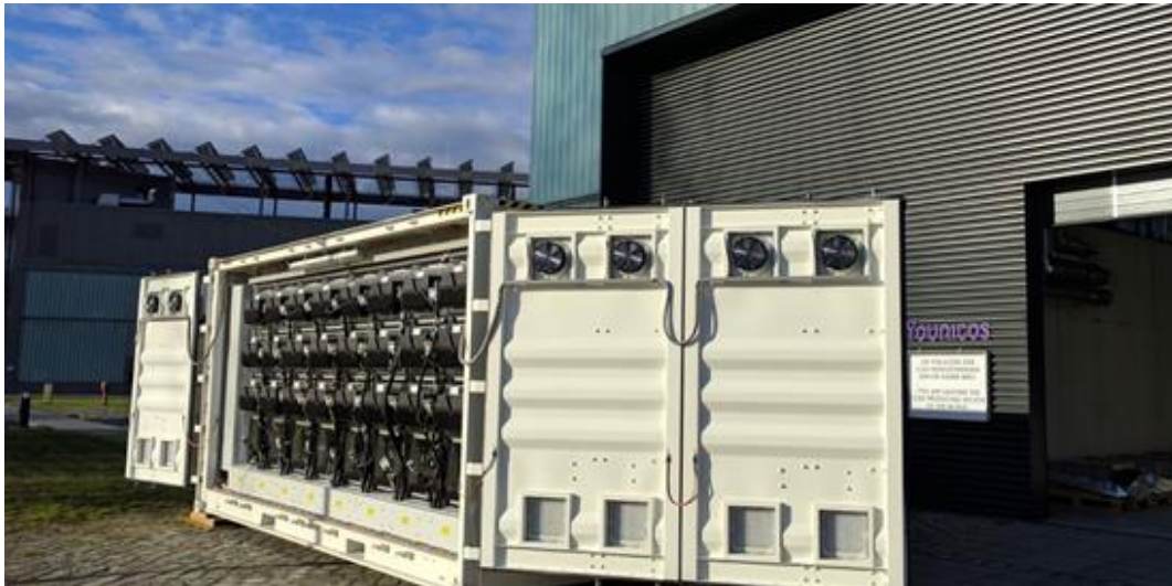
Figure I-15: Bloc de batterie avant la livraison sur Tilos
