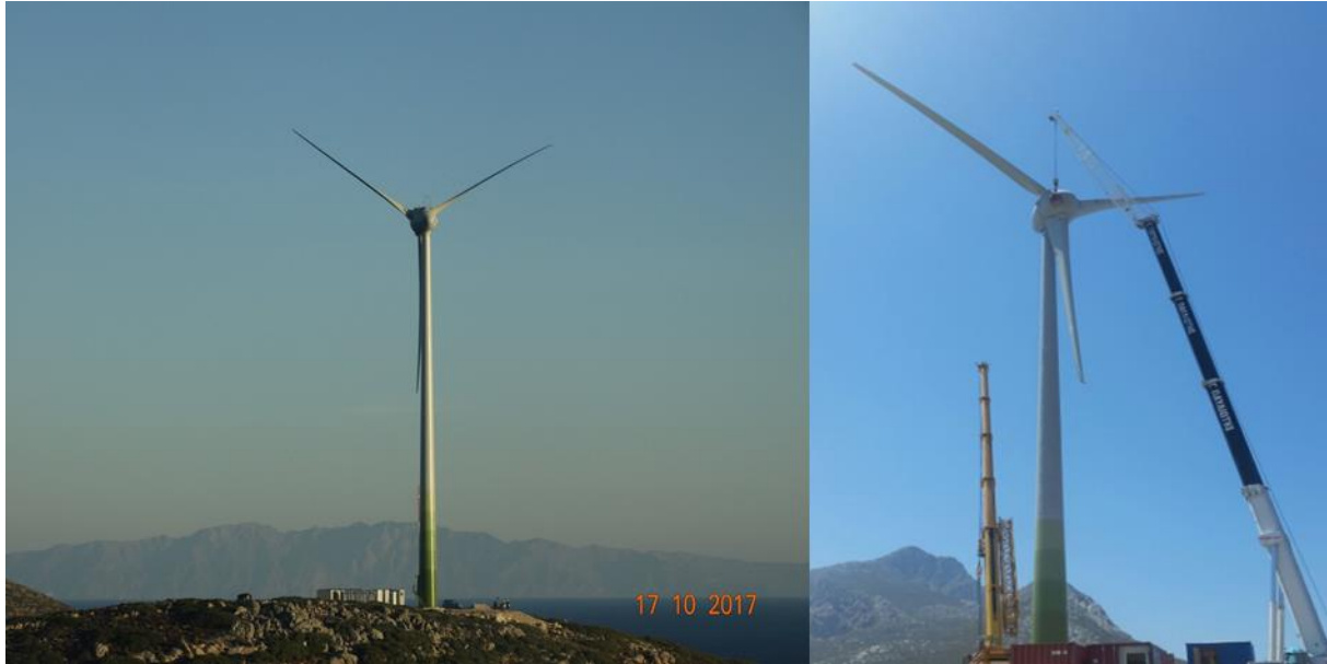
Figure I-13: Eolienne sur son emplacement sur l'île de Tilos (source : Facebook "Tilos horizon")
