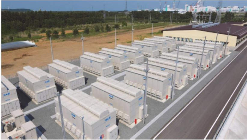
Figure 2. 7 : Ensembles de 2 MW de batteries NaS au Japon, [36].
