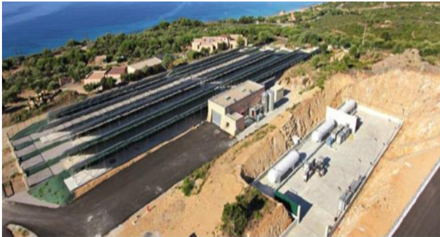
Figure 2. 9: Démonstrateur de stockage de l'hydrogène ayant récemment vu le jour en Corse.
