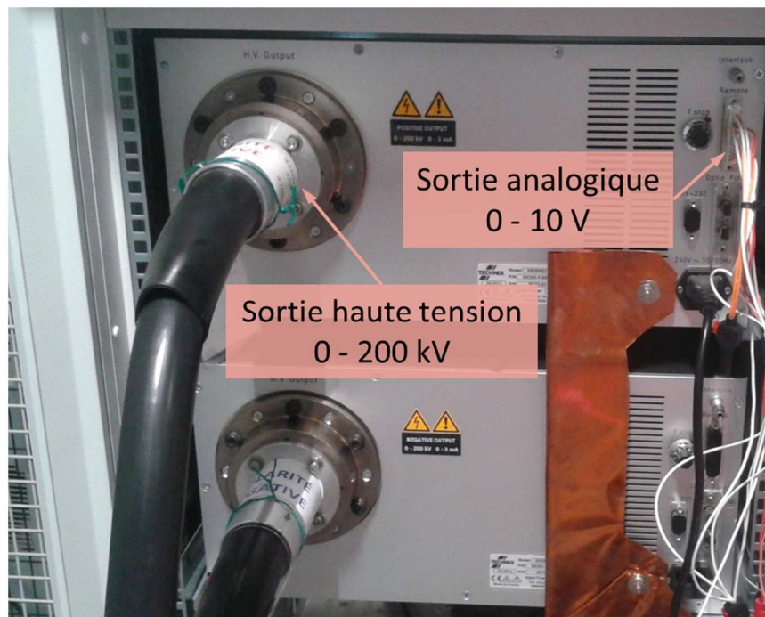
Figure 39 : Photographie de la face arrière de l'alimentation haute-tension.
