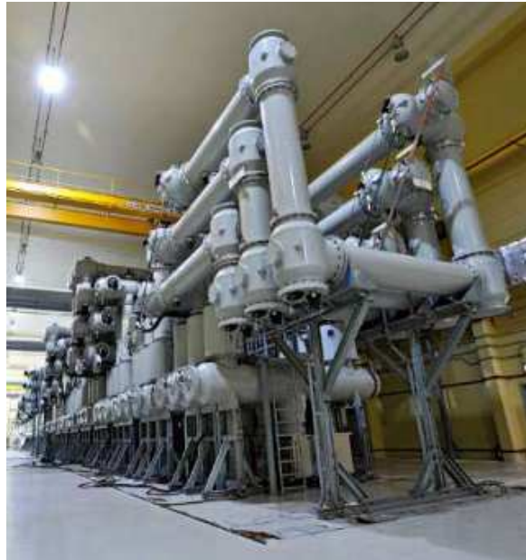
Figure 3 : Photographie d'une installation en PSEM dans un bâtiment.
