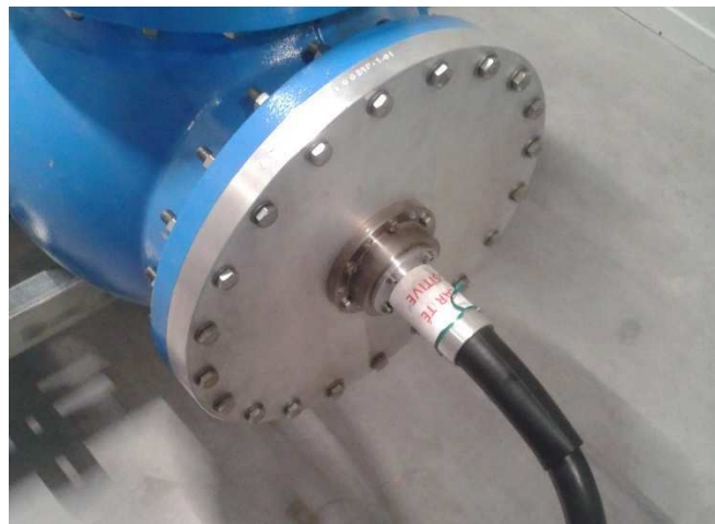
Figure 37 : photographie de l'entrée de la haute-tension dans le poste.
