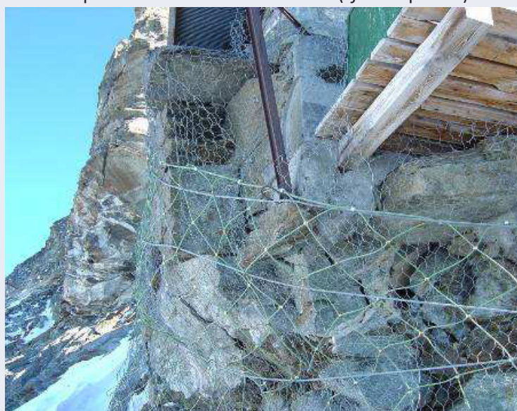
Figure 7.6. Installation de filets et rénovation des fondations du refuge Carrel (3835 m, Italie ; Vuillemier, 2014).
