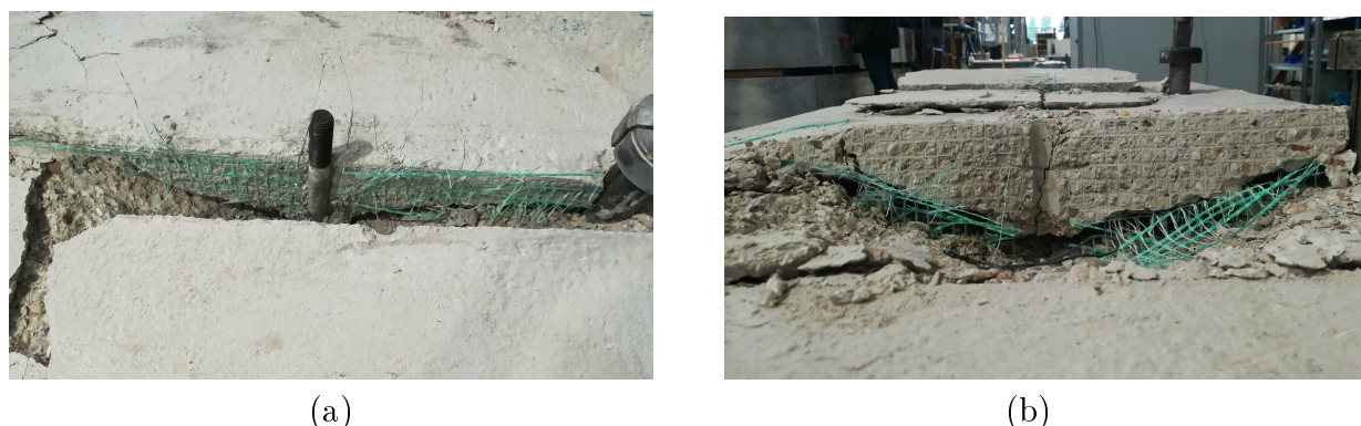
FIGURE 4.9 – Mode de rupture obtenu pour le béton C20/25 fissuré (a) vue de dessus (b) vue de côté.
