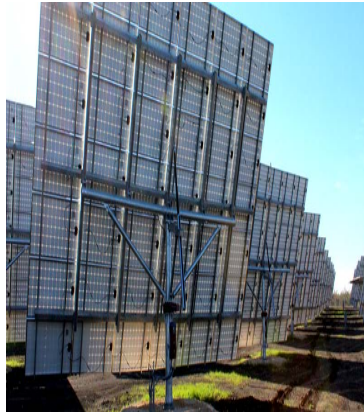
FIGURE 2.10 – Centrale de panneaux tracké sur deux axes
