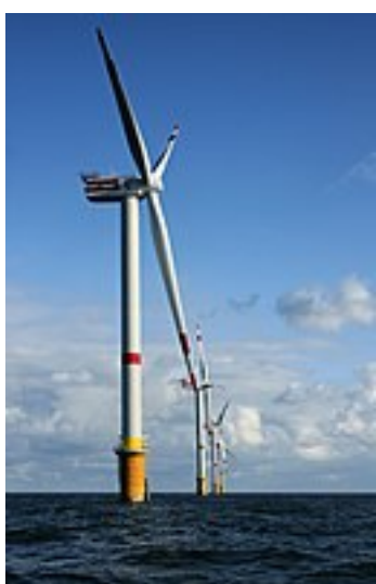
(a) Éoliennes off-shore, le modèle RePower 5M a un rotor de 126m de diamètre pour une puissance de 5MW
