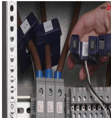
(b) Pincés ampèremétriques non intrusives dans un tableau électrique, le compteur n'est pas visible
