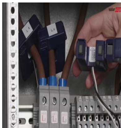
(b) Pincettes ampèremétriques non intrusives dans un tableau électrique, le compteur n'est pas visible
