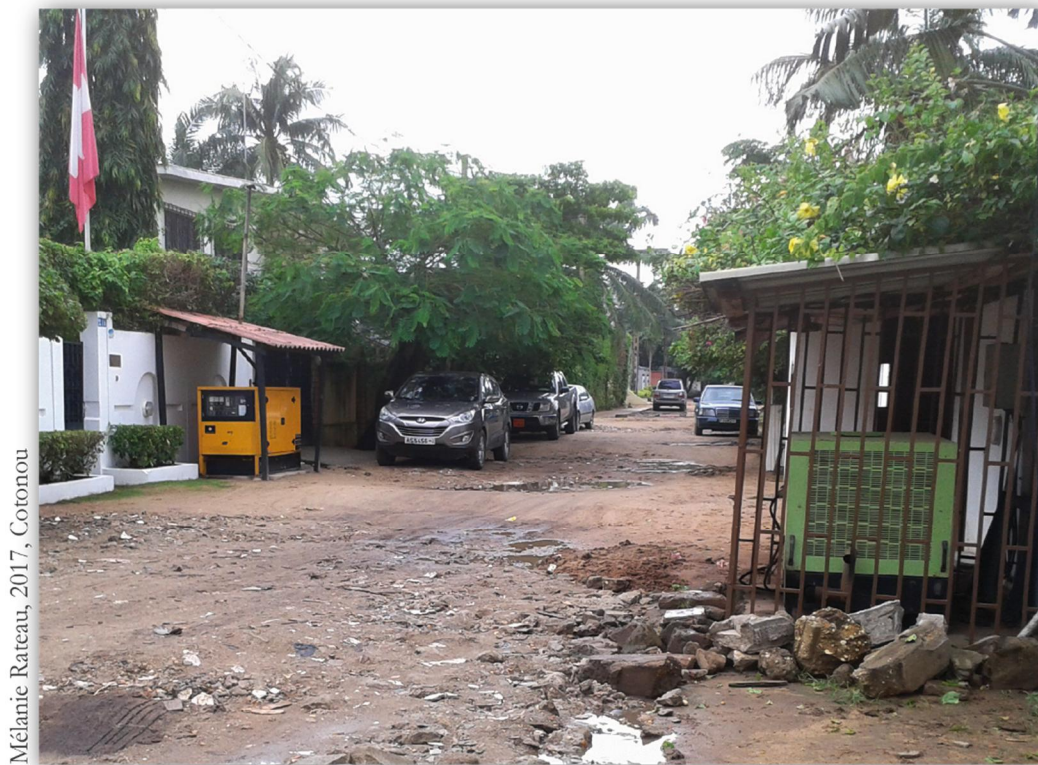
PHOTO 77 : GROUPES ÉLECTROGÈNES QUI PARSÈMENT LES ROUTES DU QUARTIER DE HAIE-VIVE
