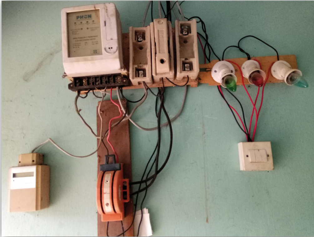
PHOTO 60 : AVERTISSEUR LUMINEUX DU RETOUR DU COURANT DANS LE RÉSEAU
