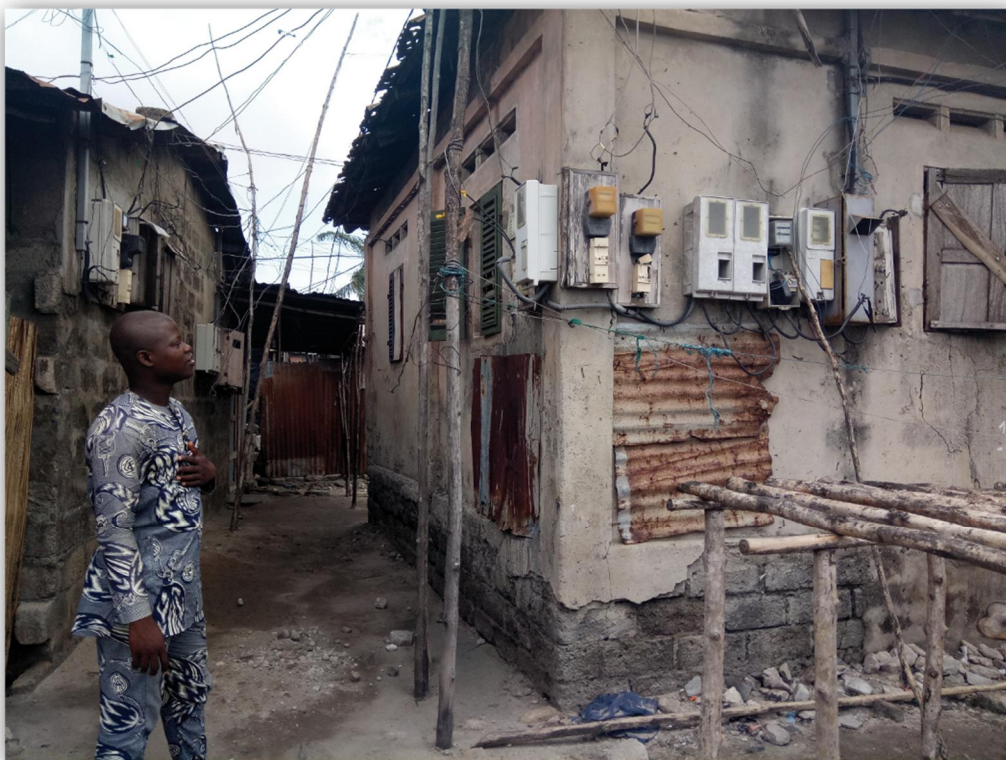
PHOTO 54 : MURS AUX COMPTEURS, DÉPART DES TOILES D'ARAIGNÉE
