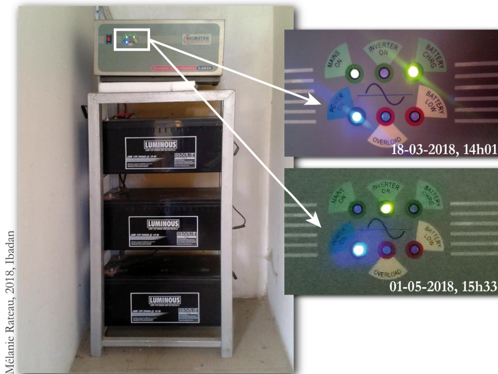
PHOTO 67 : SYSTÈME DE BATTERIES BACK-UP, ENTRE CHARGE ET FOURNITURE D'ÉLECTRICITÉ
