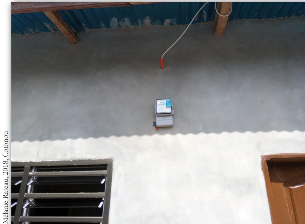
PHOTO 42 : DÉCOMPTEUR CERTIFIÉ POSÉ SUR LA FAÇADE D'UNE MAISON
