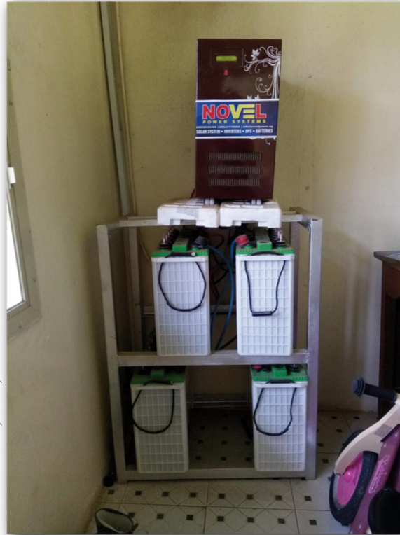
PHOTO 58 : SYSTÈME DE BATTERIES BACK-UP
