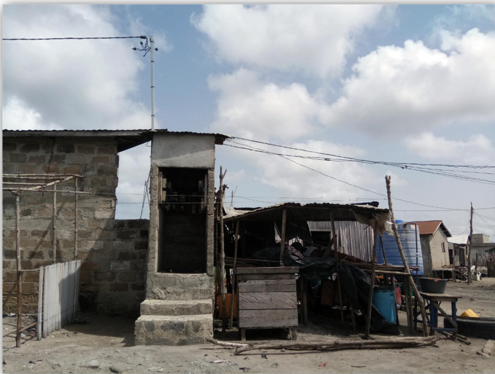
PHOTO 51 : CABANE À COMPTEURS VUE DE L'EXTÉRIEUR
