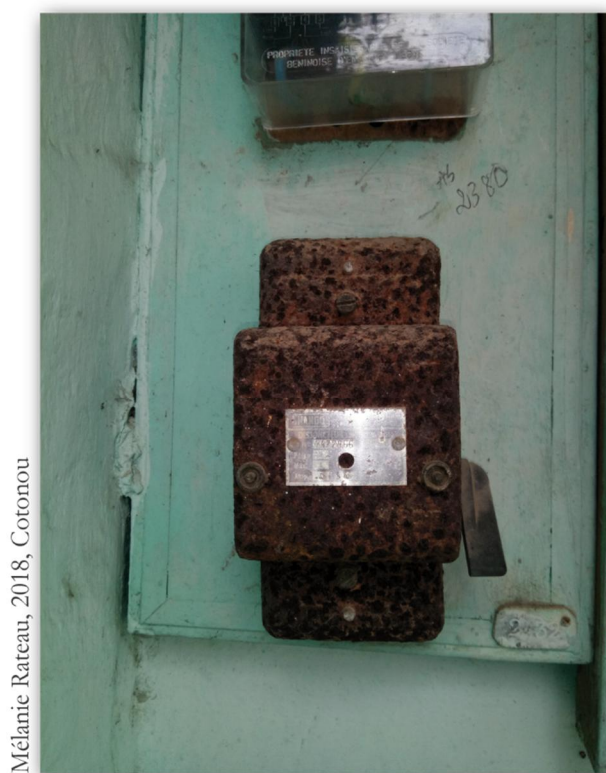
PHOTO 70 : DISJONCTEUR HORS D'ÂGE MAIS TOUJOURS EN FONCTIONNEMENT
