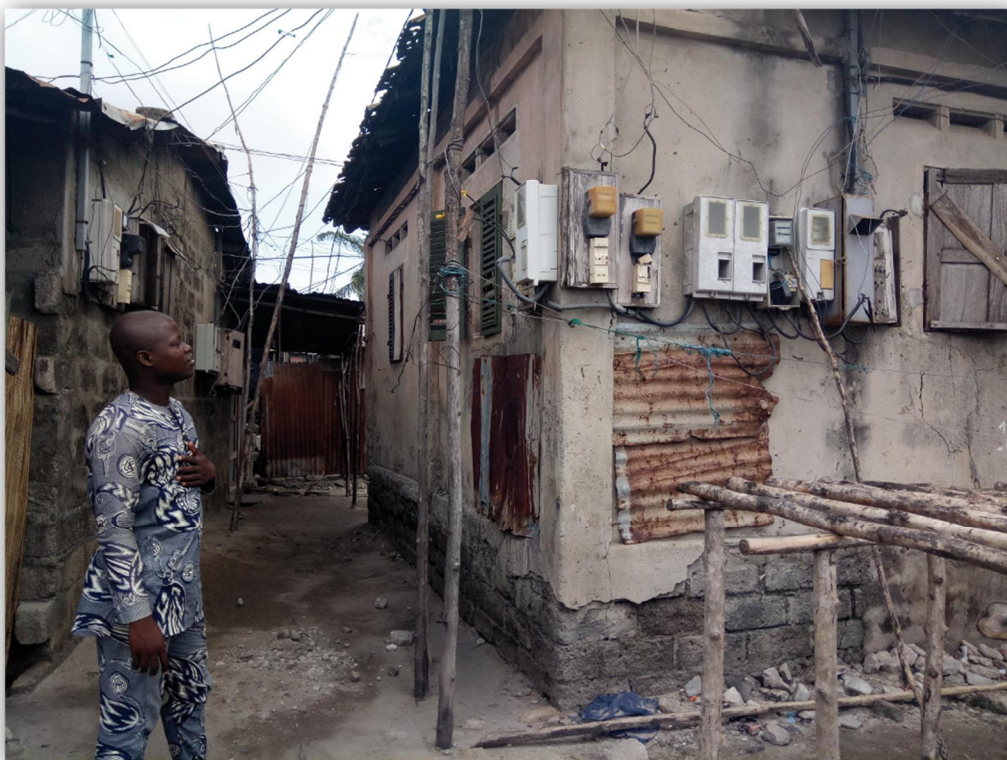
PHOTO 54 : MURS AUX COMPTEURS, DÉPART DES TOILES D'ARAIGNÉE
