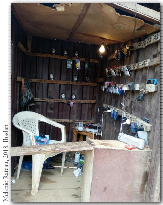
PHOTO 24 : INTÉRIEUR DE LA CABINE DE RECHARGE D'OJE
