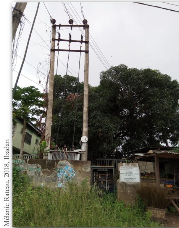
PHOTO 34 : UN TRANSFORMATEUR DE NEW-BODIJA ACCESSIBLE À TOUS
