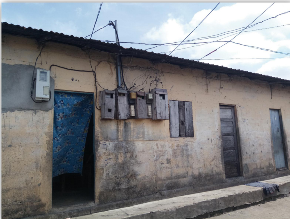
PHOTO 55 : FILS ÉLECTRIQUES AFFLEURANT LA TOITURE ET SURVOLANT LA COUR
