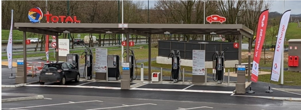
Figure 33 : Station de recharge Total composée de 6 bornes, 14 prises et 4 emplacements de stationnement.
