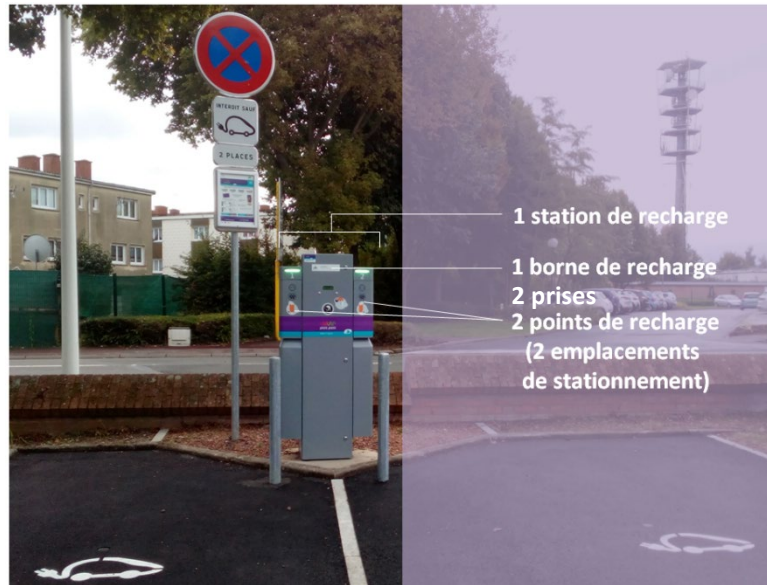
Figure 28 : Configuration d'une station de recharge accessible au public à Douai.
