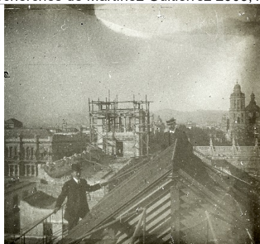
Vue de la toiture et de la structure de la verrière, avec les architectes P. Dubois et F. Marcon, lors de l'intervention dans le grand magasin entre 1909 et 1911 2016.10.15_1g, fonds Marcon, MDLV.
