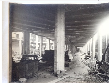
F. Marcon, construction intérieure (poutres et colonnes en béton armé), cote : 2016.10.15_2c, fonds Marcon, MDLV.
