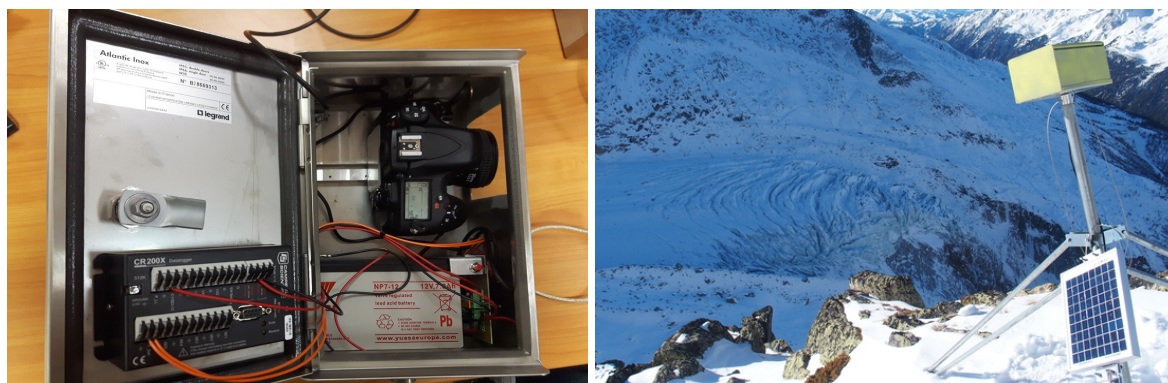
FIGURE 5.8 – Appareil-photo droit programmé, installé dans un boîtier, alimenté par un panneau photovoltaïque et monté sur une installation métallique avec une vue rasante sur le glacier d'Argentière.
