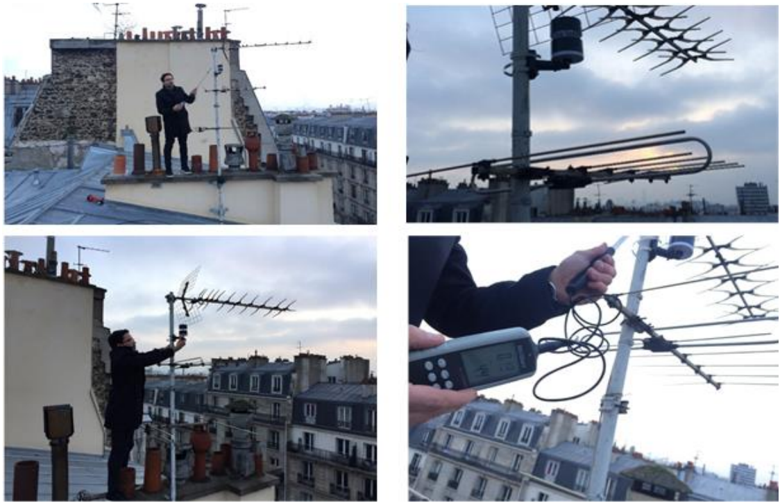
Figure 91. Installation de l'anémomètre sur le toit du bâtiment 136 avenue Parmentier, Paris 11ème. Une antenne de TV a servi de support de fixation du dispositif.
