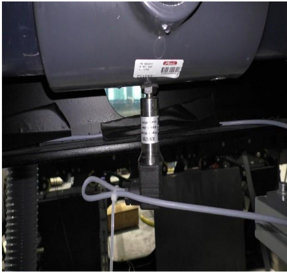
Figure III. 9 : sonde de pression à l'amont du collecteur
