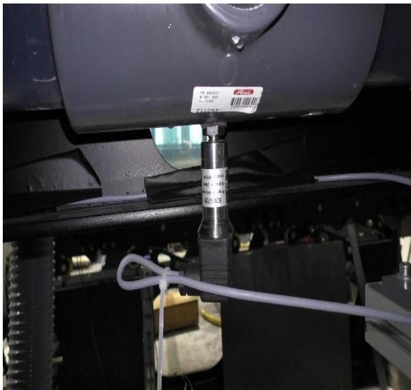
Figure III. 9 : sonde de pression à l'amont du collecteur
