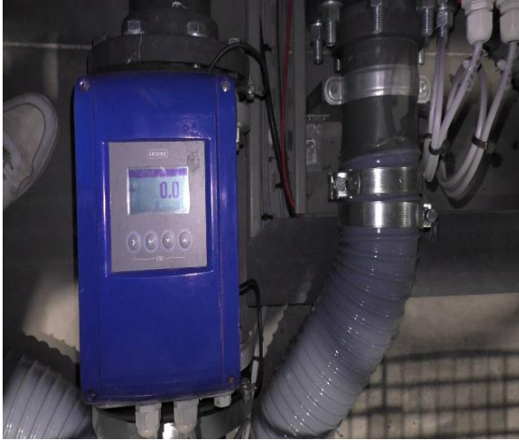
Figure III. 10 : lecteur installé sur un débitmètre électromagnétique
