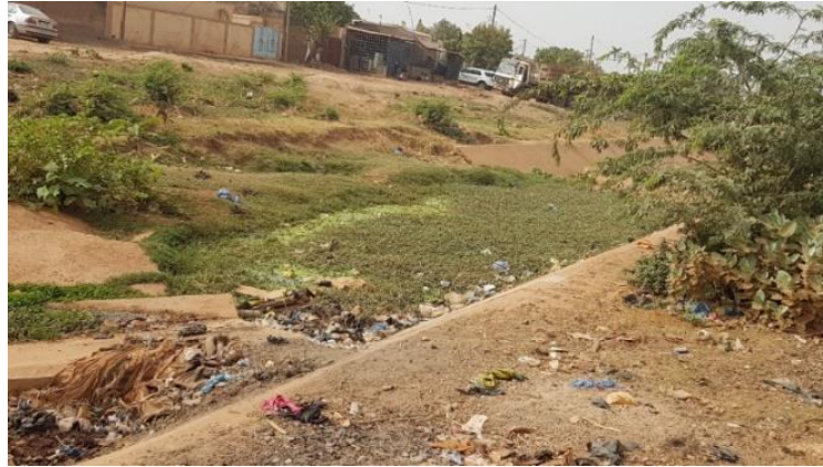
Photographie IV-5 : État d'obstruction du collecteur de Wemtenga à Ouagadougou (source : auteur)
