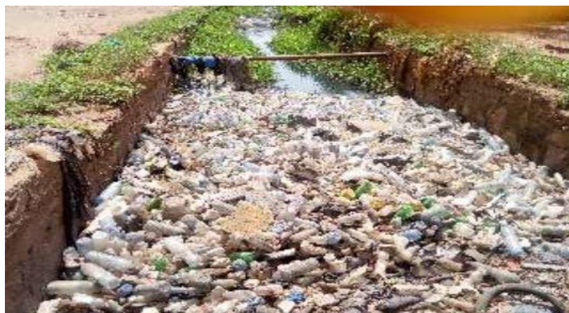
Photographie IV-4 : État d'obstruction du collecteur du carré des martyrs à Bamako (source : [CAEB, 2018])
