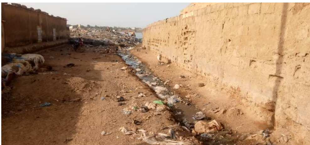
Photographie III-1 : Canalisation de fortune réalisée par les populations pour permettre les écoulements vers le barrage n° 2 de Ouagagadougou (source : auteur)
