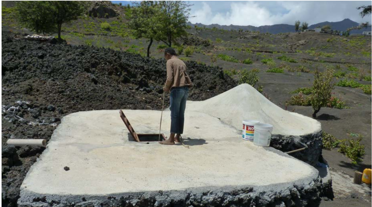
Figure 6.24. Méthode de récupération de l'eau de pluie et de stockage de l'eau à Chã das Caldeiras (Sanial, juillet 2013).
