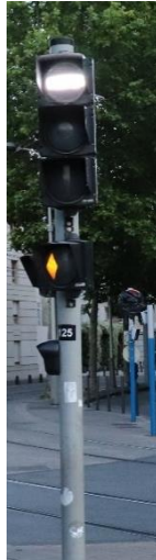
Figure 77 : Exemple de feux R17 avec SAC
