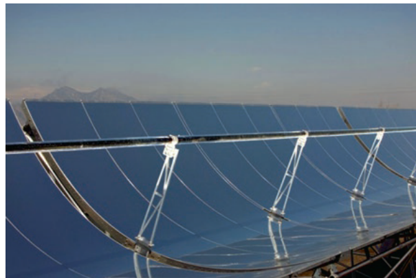
FIGURE 1.17 – Capteurs solaires à auge parabolique avec fluide caloporteur dans le tube absorbant l'énergie thermique [32]
