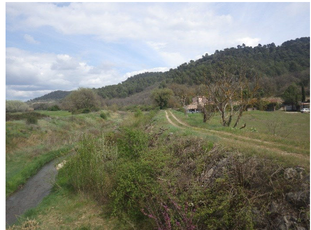
Photo 2 : Dignes de protection contre les inondations. Les enrochements (à droite) constituant la digue sont recouverts de végétation ligneuse rendant l'inspection visuelle difficile (Photo : Macia J., 2015).
