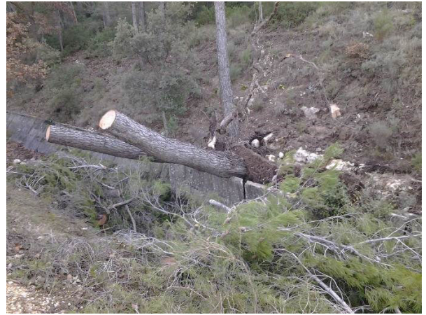
Photo I. 4 : Basculement du bajoyer suite au basculement d'un arbre (Photo : Zanetti C., 2010).
