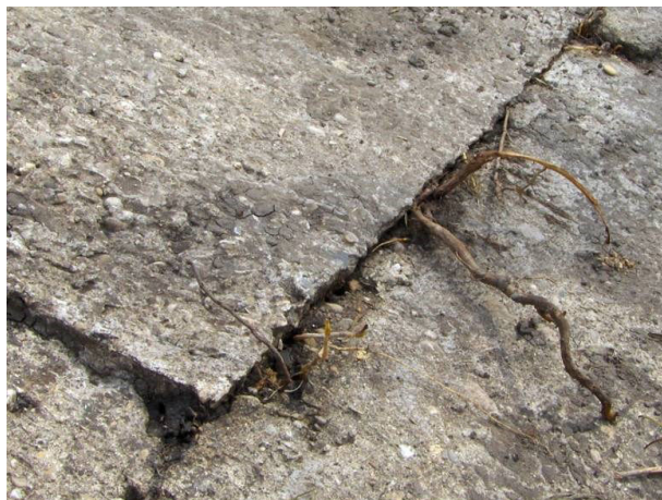
Photo I. 5 : Soulèvement d'une dalle et risque d'infiltrations par les racines (Photo : Zanetti C., 2010).
