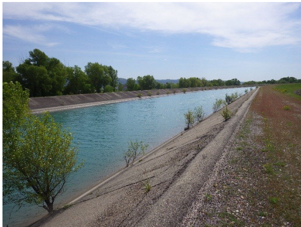
Photo 1 : Canal hydroélectrique. Les parois (bajoyers) des canaux sont colonisées par des Peupliers noirs qui dégradent le revêtement étanche (Photo : Macia J., 2015).
