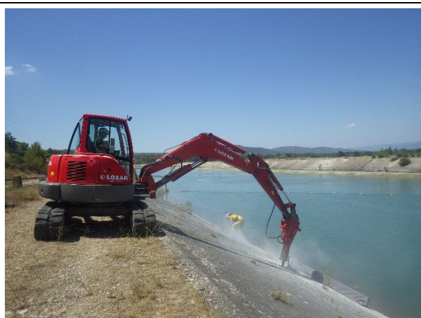
Photo 3 : Utilisation d'un brise-roche hydraulique lors de travaux de dessouchage sur un canal hydroélectrique (pollution de l'air par poussière et particules fines – gaz d'échappement et risque de pollution hydrocarbures) (Photo : Macia J., 2015).
