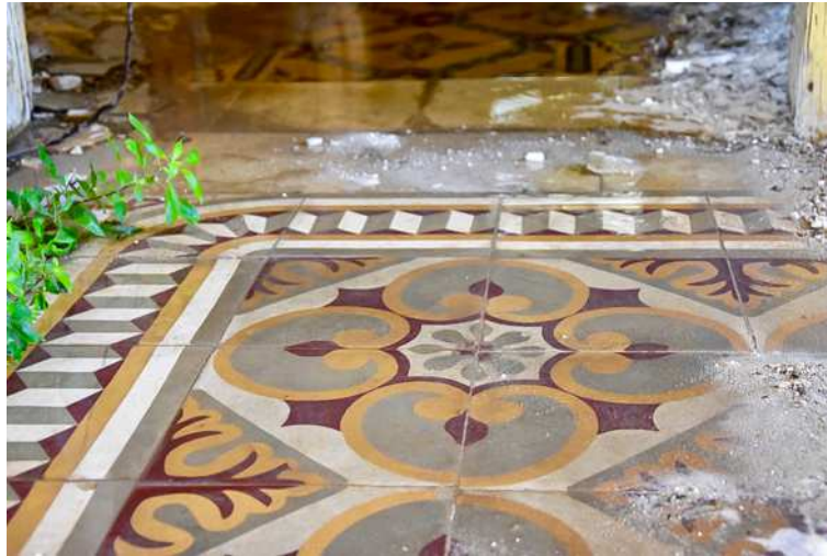
Sol couvert par des carreaux de ciment colorés dans une ancienne maison abandonnée. Crédit : Amani Fares, 20/06/2018
