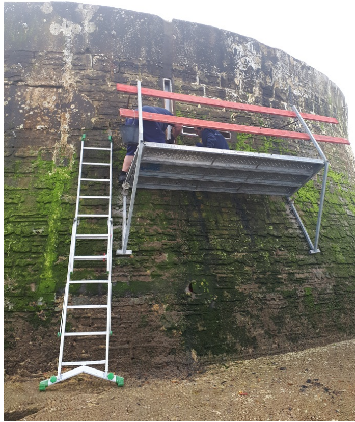
FIGURE C.3 Photo de deux agents du CD64 finalisant la mise en place des caissons sur lesquels les plaques des capteurs vont être fixées.
