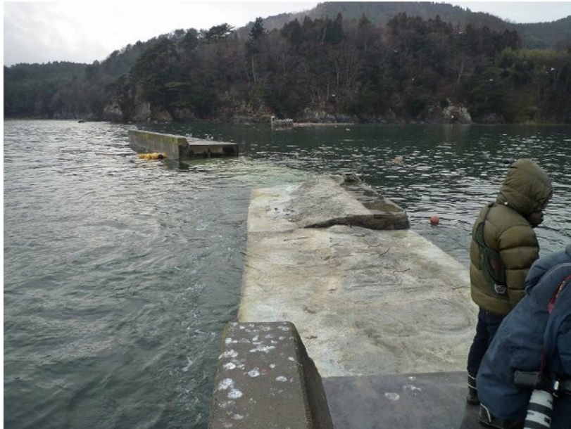
FIGURE 1.11 Brise-lames détruit à Takenoura, Japon, lors du tsunami en 2011 [21].
