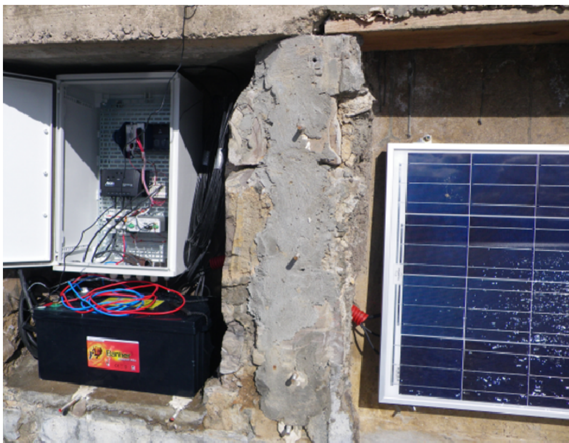
FIGURE 3.15 Photo du panneau solaire et de l'installation électrique intégrée dans la digue.
