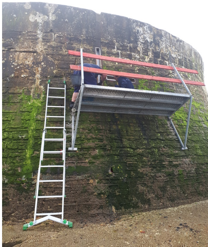
FIGURE C.3 Photo de deux agents du CD64 finalisant la mise en place des caissons sur lesquels les plaques des capteurs vont être fixées.
