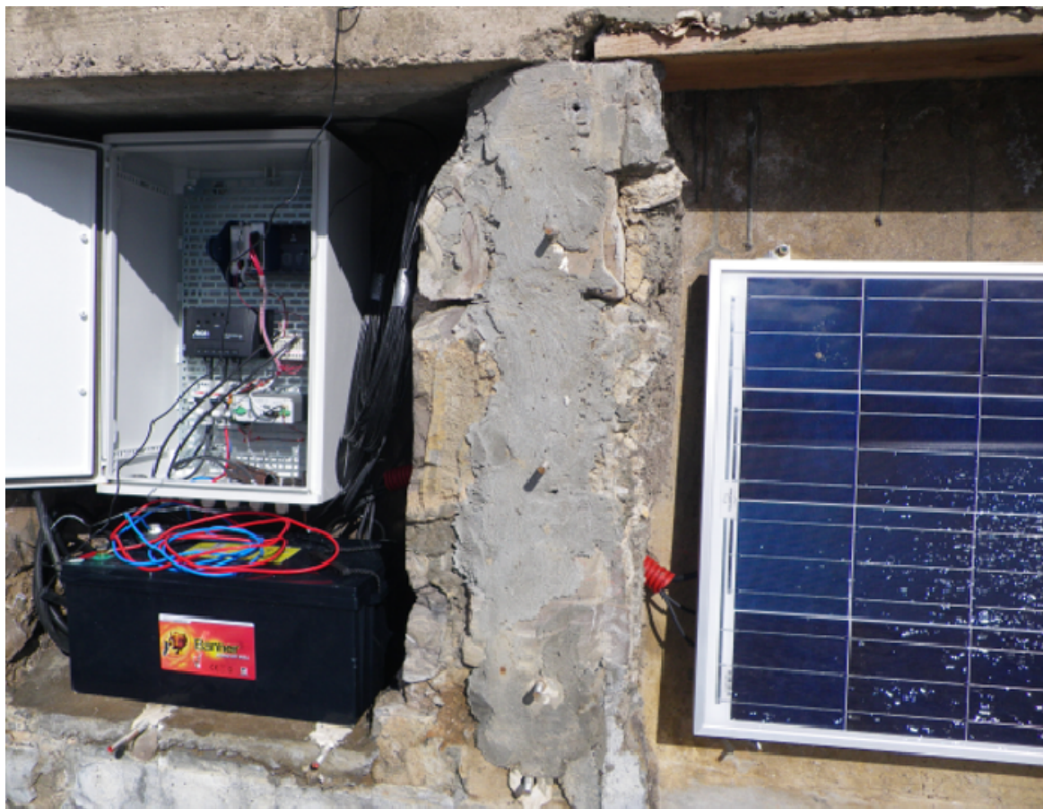
FIGURE 3.15 Photo du panneau solaire et de l'installation électrique intégrée dans la digue.
