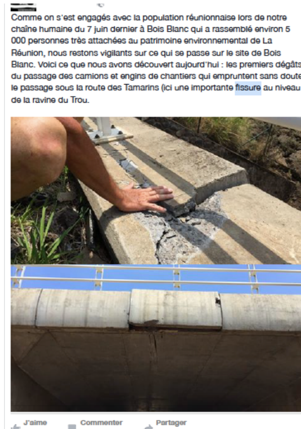
Illustration 4. Publication contenant la photo d'une fissure de la route des Tamarins
