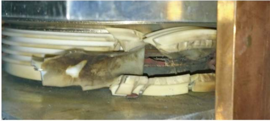
Figure II.2: Diode explosée à cause d'un trop fort di/dt [15].
