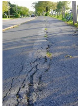
Affaissement de rive
