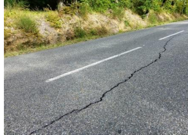
Annexe 1. Photographies des différentes déformations possibles d'une route
